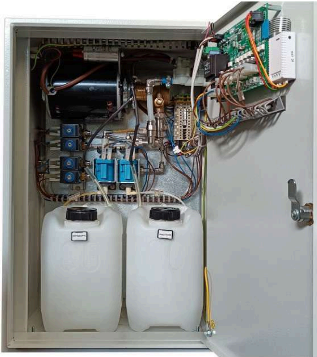
Figura 6 - Zona "Q": circuito elettrico della centralina
