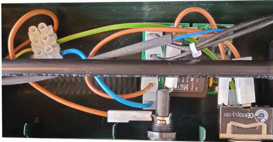
Figura 6 - Zona "Q": circuito elettrico della centralina
